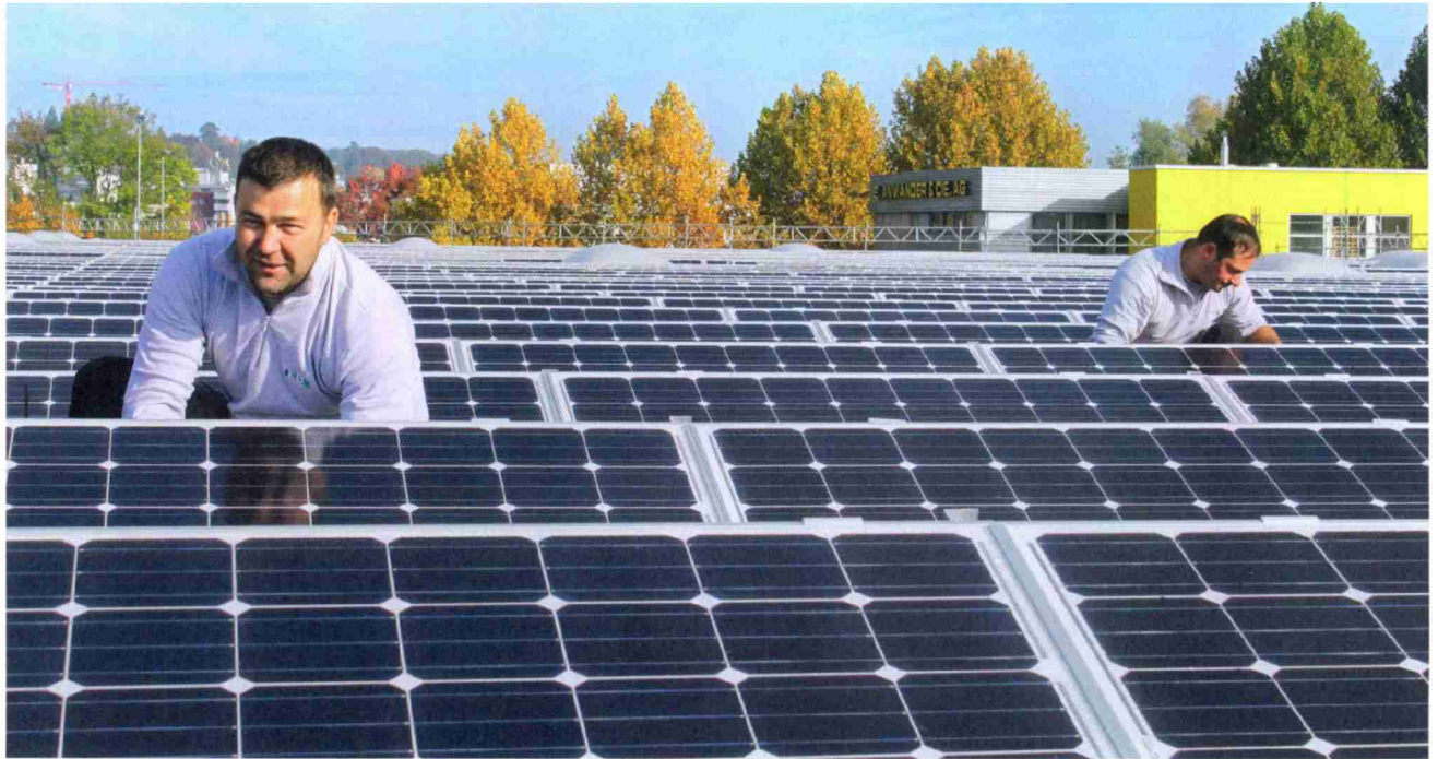
Solaranlage der Baselland Transport AG in Oberwil: Kantonale Subventionen machten den Bau möglich.
